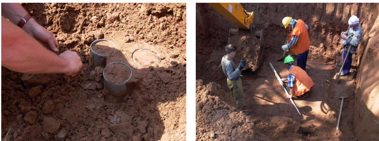
Рис. 6. Отбор монолитов супеси. Штамп номер 3 и подготовка дна выработки перед установкой штампа
