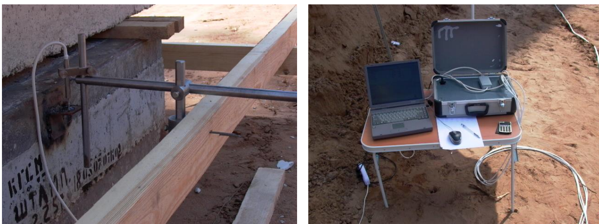
Рис. 5. Датчик перемещений и его крепление к реперной системе и блок регистрирующей аппаратуры с компьютером
