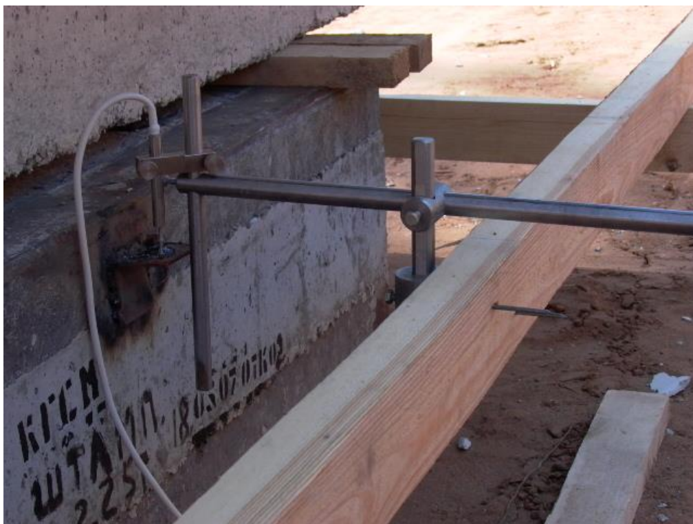
Рис. 9. Датчик перемещений и его крепление к реперной системе
